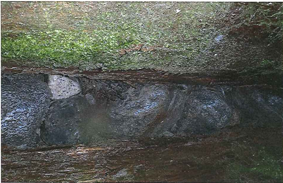
CK2267 fill failing
